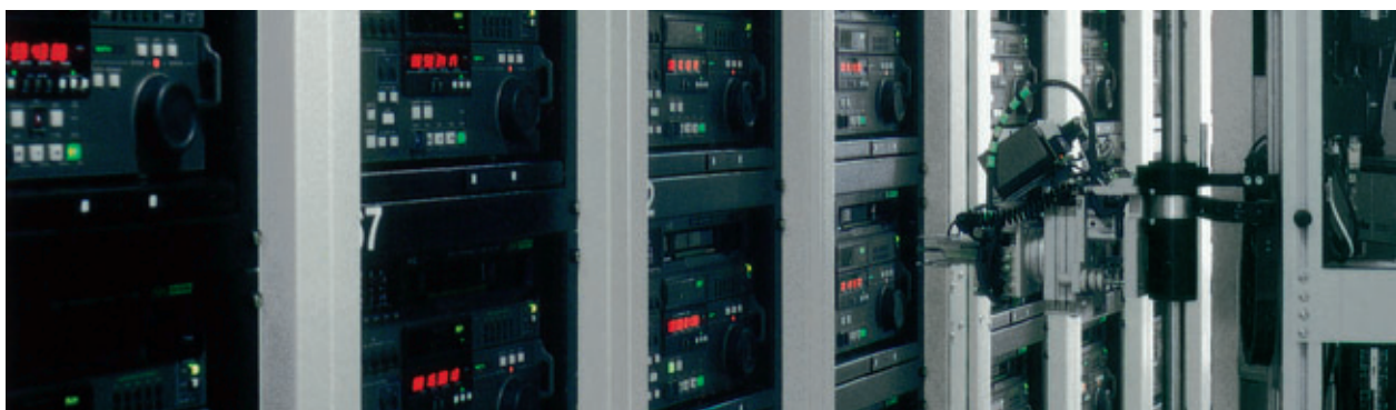
Installation de diffusion entièrement automatisée chez l'opérateur Premiere, Allemagne
